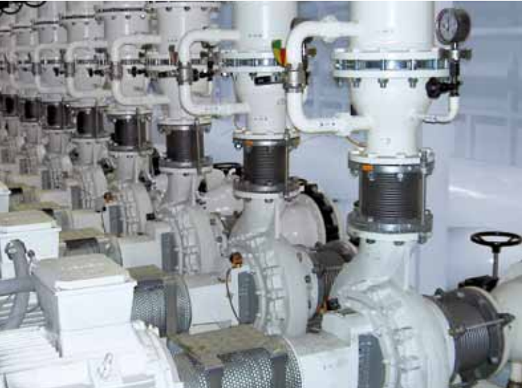
Systempumpenstation einer herkömmlichen KSS-Filteranlage
